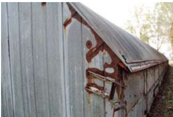
Figura 7. Struttura di allevamento arrugginita con crepe e fessure
